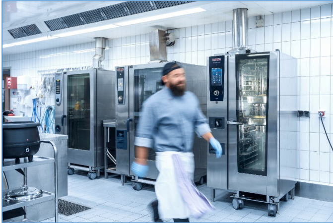
Abb. 41: Heißluftdämpfer mit Abdampfrohren in die Ablufthauben der Küche (© Rational AG)
